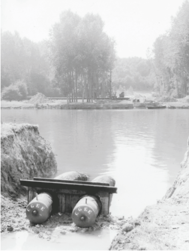
1959 Passage de la conduite du gaz de Lacq au-dessus de la Seine.
